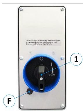
Figure 17 : commutateur de la machine (3,0 à 7,5 kW)
