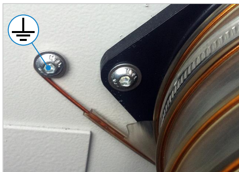
Figure 19 : mise à la terre du tuyau d'aspiration
